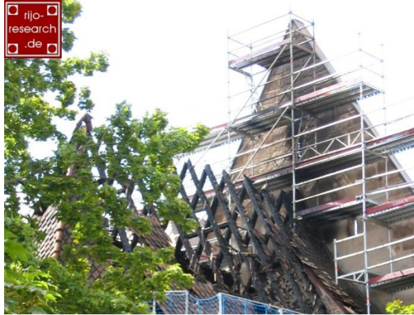
Giebelwand und abgebrannter Dachstuhl des Chors von St. Martha am 5.6.2014 (Foto: Gerhard Jochem)
